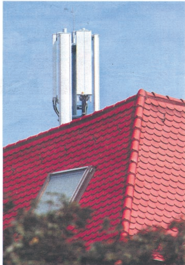
Über diese Mobilfunkantenne in der Bismarckstraße sind etliche Anwohner besorgt. Foto: Leif Piechowski
